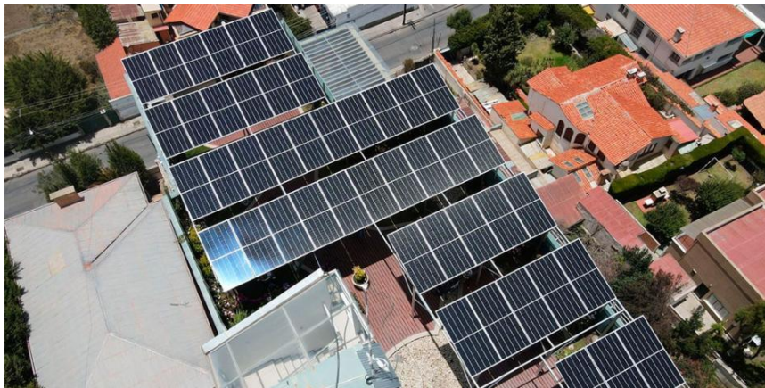
Panneaux solaires au siège de CRECER IFD
