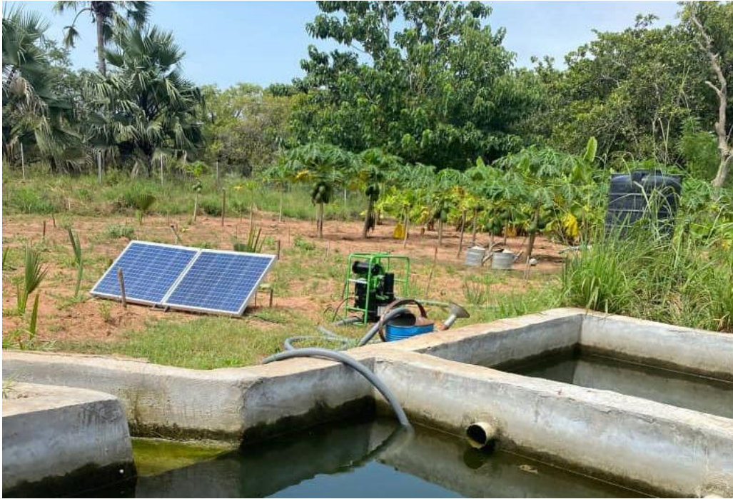
Los beneficiarios de UBTEC pueden equiparse con sistemas solares de bombeo y riego.
